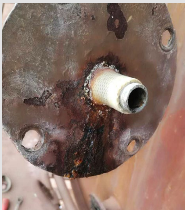
25 jours après l'installation de Vulcan, la situation d'entartrage s'était déjà nettement améliorée.
