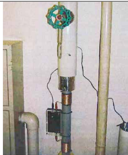
Vulcan 5000 a été installé dans la cuisine de l'usine
