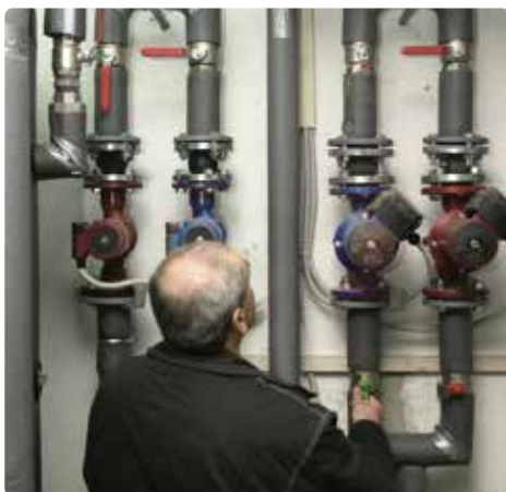
Трубопроводная система в многоквартирном доме
