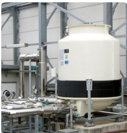
Torre di raffreddamento
