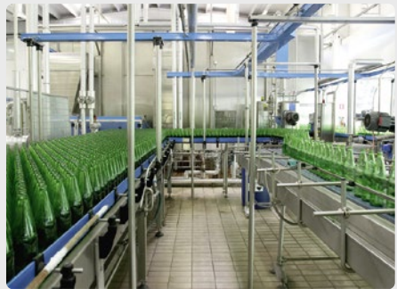
Impianto di imbottigliamento
