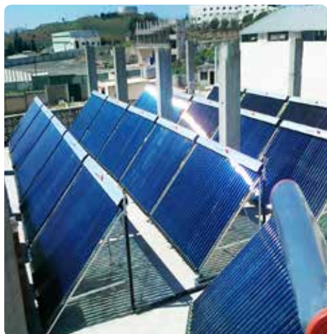
一间公寓的太阳能加热板
