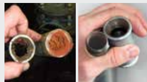
Sistema de tuberías
