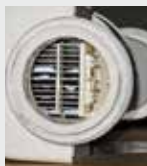
Filtro de la piscina
