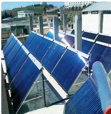
Pannelli solari in un condominio
