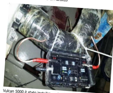
Vulcan 5000 è stato installato sul tubo d'ingresso del locale per il riciclaggio dell'acqua.
