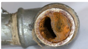
Tubo con depositi di calcare
